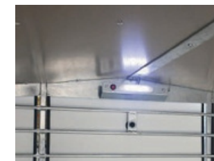
Vnitřní LED osvětlení
